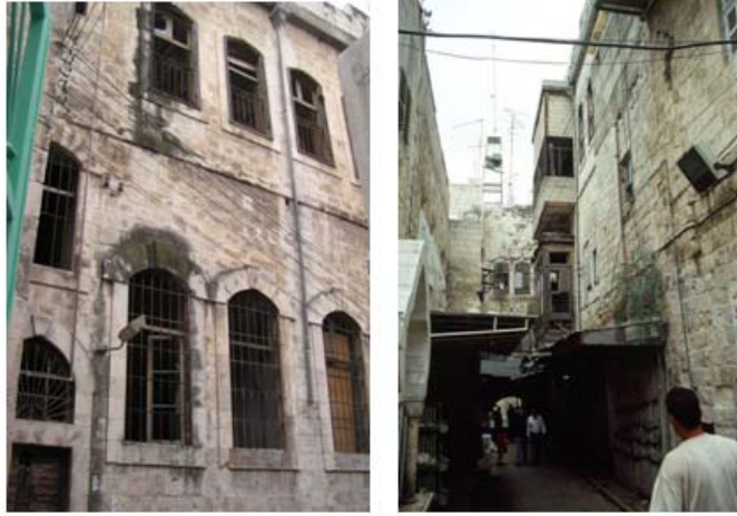
شكل (4:79): صور توضح التآكل والعفونة.
