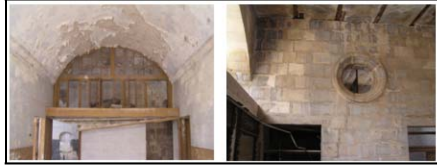
شكل (4:82): صورة توضح التشققات في الواجهات الداخلية.
