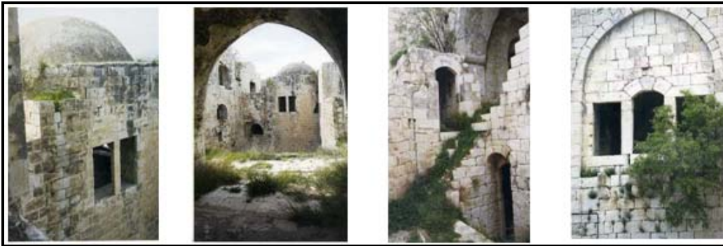
شكل (4:52): صور توثيقية تظهر الأشجار والطحالب التي نبتت على الواجهات، وتوضح حالة الحجر. المصدر: (موقدي، 2006)
