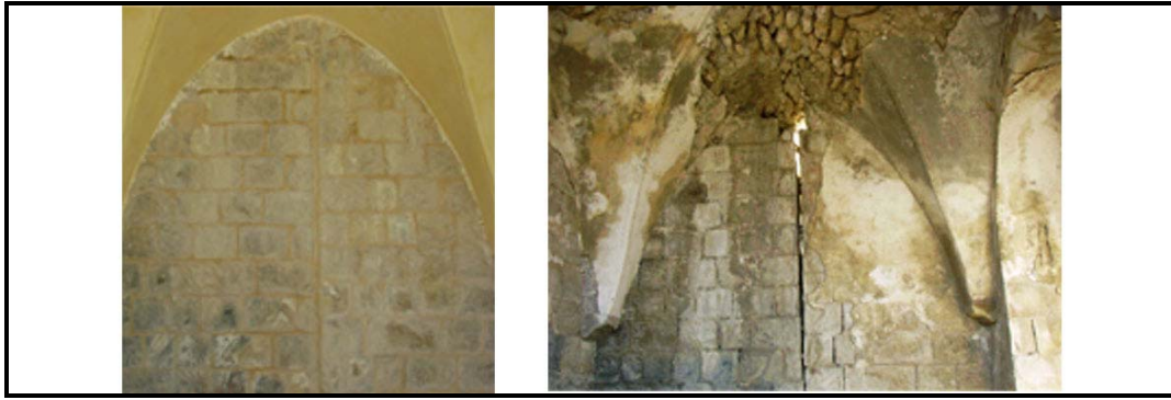
شكل (70:4): إغلاق الشقوق بتعبئة المونة داخلها. المصدر: (صالح، 2006).
